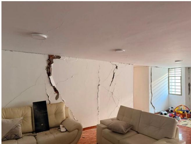
Imagen 38. Muro afectado segundo piso
