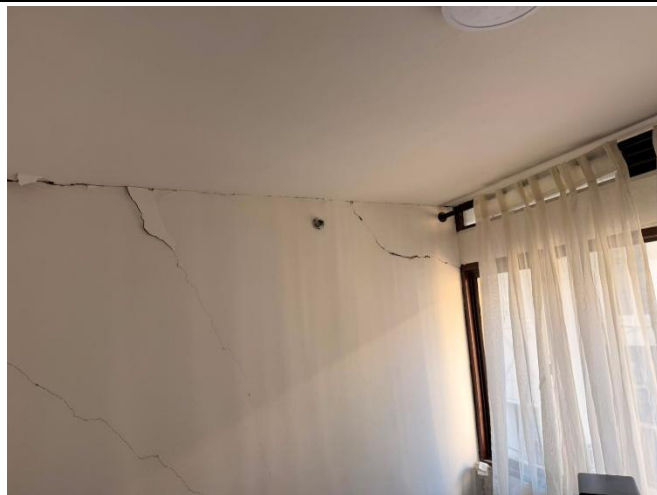
Imagen 46. Muro afectado cuarto piso
