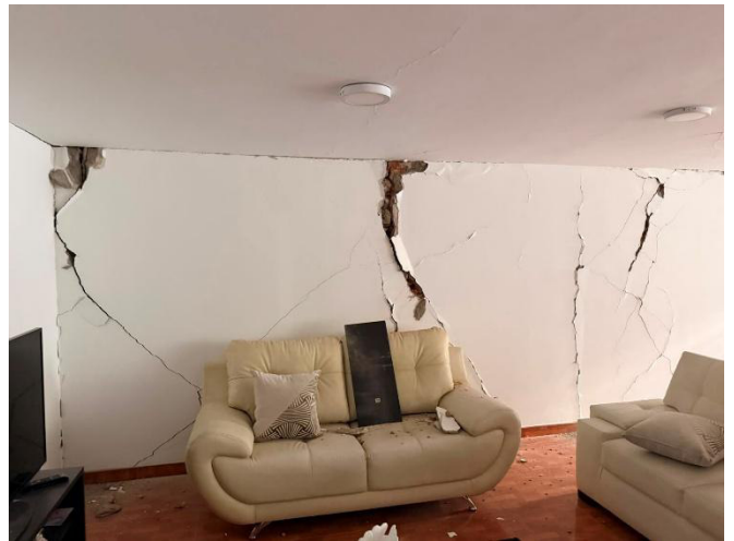
Imagen 39. Muro afectado segundo piso
