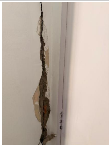
Imagen 34. Muro afectado primer piso
