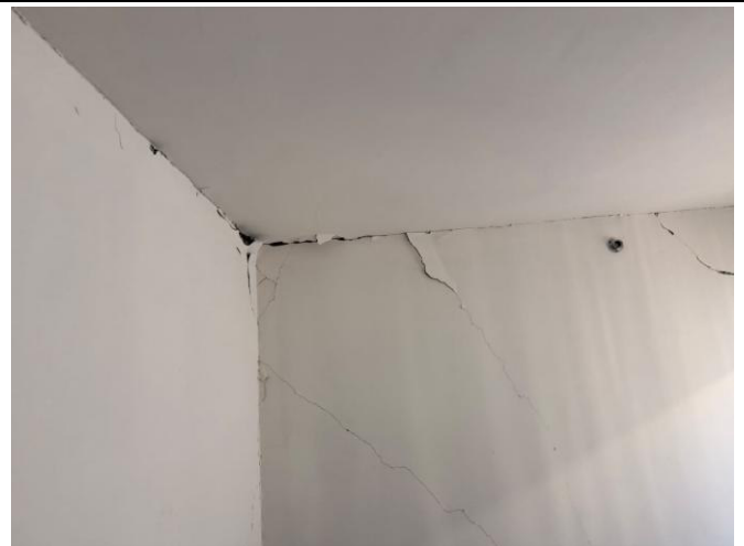
Imagen 47. Muro afectado cuarto piso
