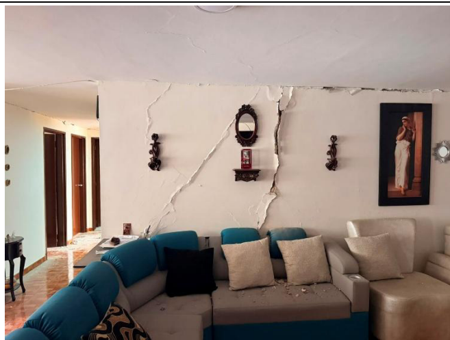
Imagen 40. Muro afectado segundo piso
