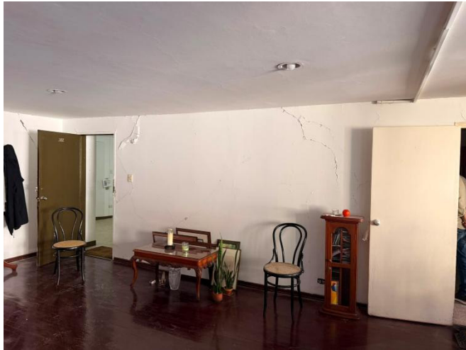
Imagen 44. Muro afectado cuarto piso
