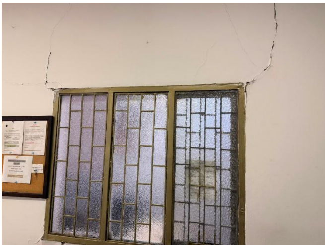
Imagen 30. Muro afectado primer piso
