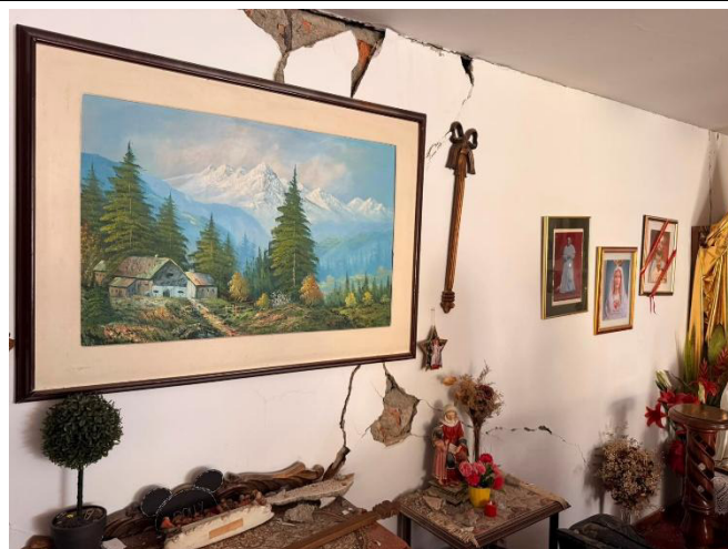
Imagen 37. Muro afectado segundo piso
