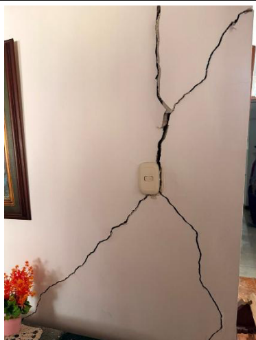
Imagen 36. Muro afectado segundo piso
