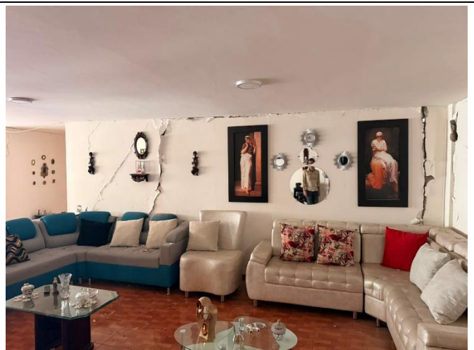
Imagen 41. Muro afectado segundo piso
