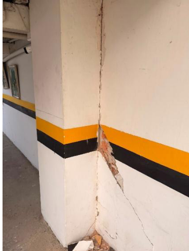
Imagen 26. Muro afectado en sótano de
