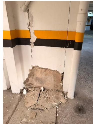
Imagen 25. Muro afectado en sótano de parqueadero
